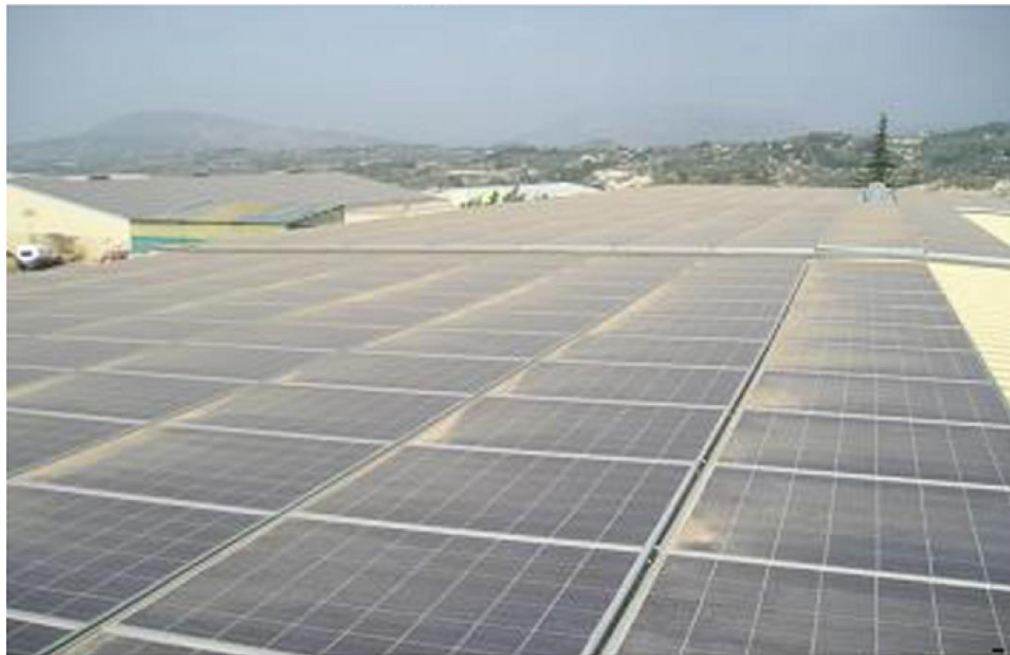
Figura 23. Sujidade depositada de forma não uniforme em um arranjo FV instalado sobre o telhado de uma indústria
